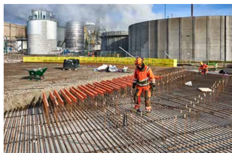
Den omfattande armeringen för bottenplattan till en av dom nya bassängerna för rening av processvatten.
